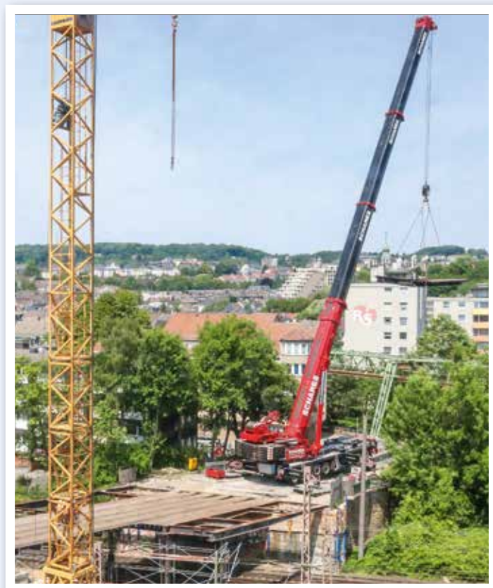
Beim Brückenabriss steht der LTM 1500-8.1 von Schares mit vollausgefahrenem 50 m Ausleger sowie 90 t Ballast an der Brückenkante und hebt bei rund 20 m Ausladung bis zu 45 t schwere Brückenteile. Bild: Michael Bergmann
