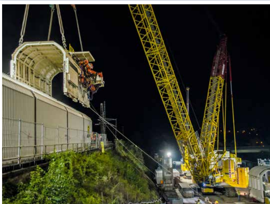
Der Demag CC3800 von Steil Kranarbeiten hebt ein einer Tunnelbaustelle an der Mosel ein neuartiges Bohrgerät in Position.
