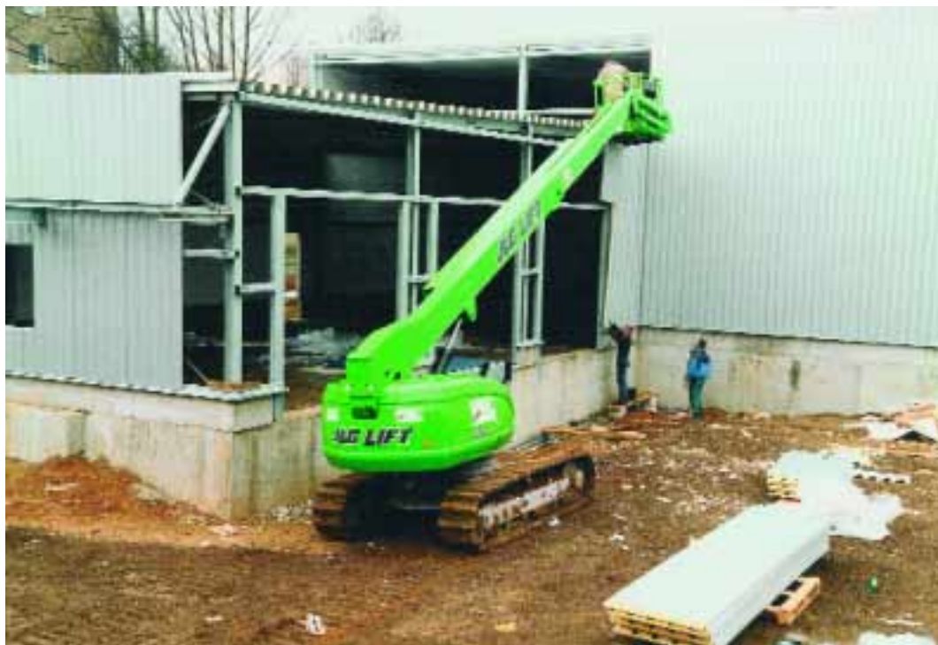
20,12 m Plattformhöhe und 17,27 m seitliche Reichweite bietet die mit Raupenfahrwerk ausgerüstete JLG-Hubarbeitsbühne 660 SJC – hier im Einsatz beim Bau eines Möbellagers in Bonn-Mehlem.
