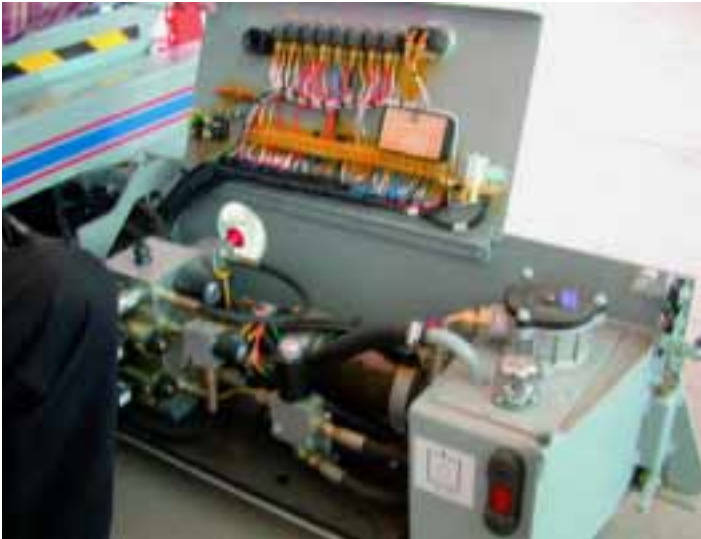
Auch bei älteren Arbeitsbühnen ist die Verkabelung beinahe identisch.
