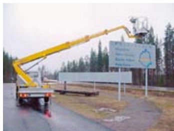
Zwei 3,5 t-Lkw-Arbeitsbühnen bietet die Omme Lift nun verstärkt auf dem deutschen Markt an. Darunter auch die 1750 ETZJ, die 18,9 m Arbeitshöhe und 10,5 m seitliche Reichweite zur Verfügung stellt – auch am Polarkreis.
