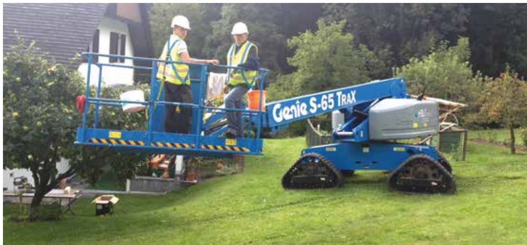
Die Genie S-65 Trax Arbeitsbühne musste schwieriges Gelände mit Hängen beim Reparatursatz am Dach eines Berghauses in den steiermärkischen Alpen in Österreich meistern.
