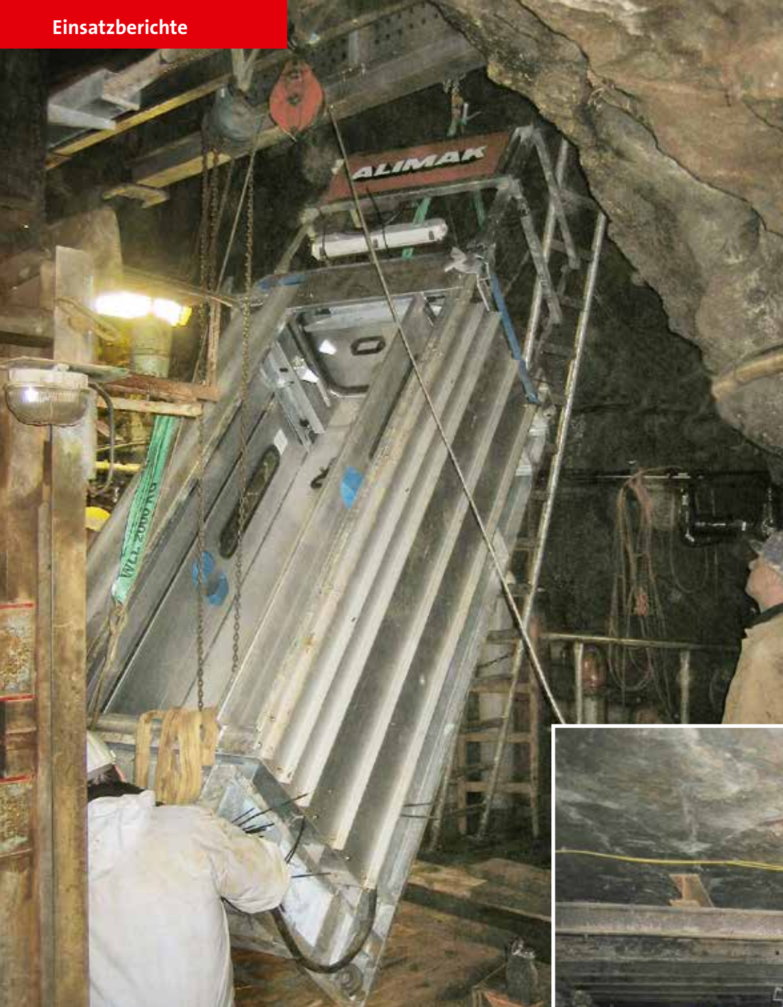
ALIMAK SE-Kabine auf dem Weg nach unten.
