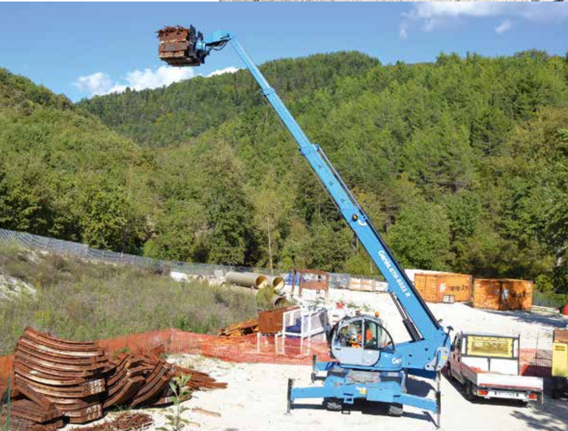
Der Genie GTH-5021 R beim Transport von 2 Tonnen schweren Paletten mit Stahlträgern zum Stolleneingang.
