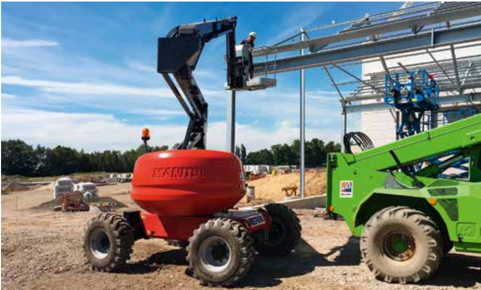
Die von HKL angemietete Gelenk-Teleskopbühne ist perfekt für Arbeiten an schwer zugänglichen Stellen geeignet.
