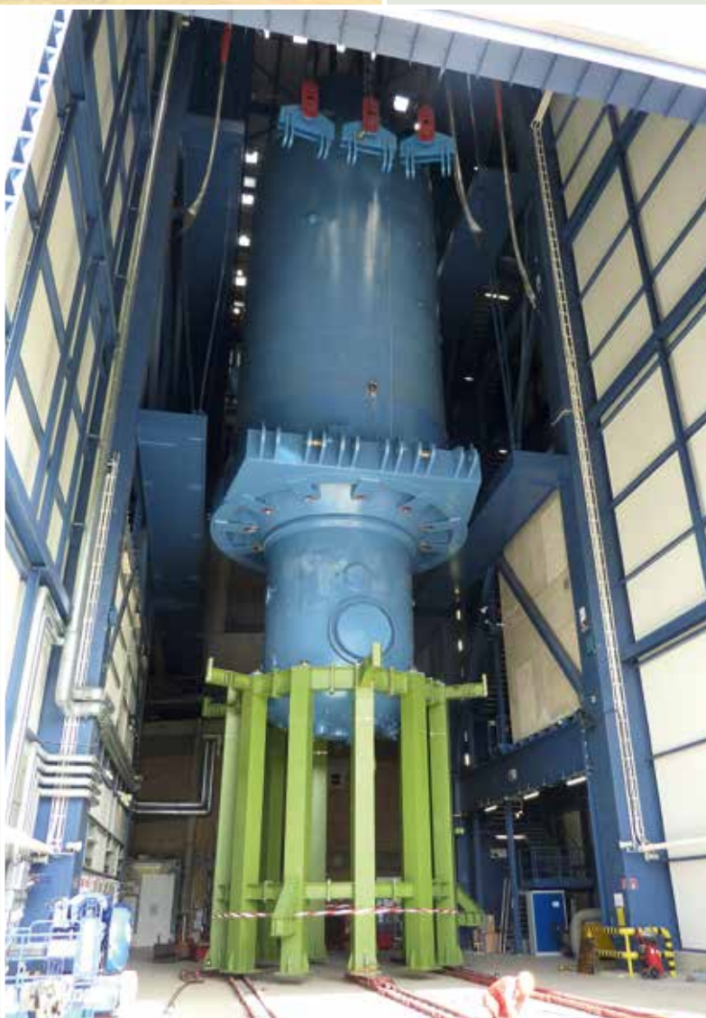
Die Verfüllung des Reaktorbehälters mit Porenleichtbeton wurde in mehreren Schritten durchgeführt. Die niedrige Dichte von nur 0,7 Kilogramm pro Kubikdezimeter wurde durch die Zugabe von hohlen Glaskügelchen mit einem Durchmesser von 0,1 und 0,2 mm erreicht.
