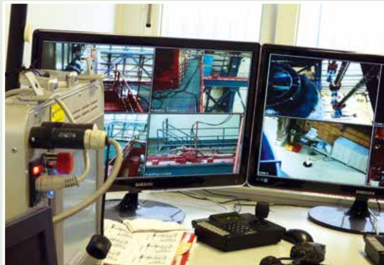
Von hier aus wird die Brückenkrans-Verschubbahn-Konstruktion mit ihren vier Hublitzenebern überwacht und bedient. KM-Bild
