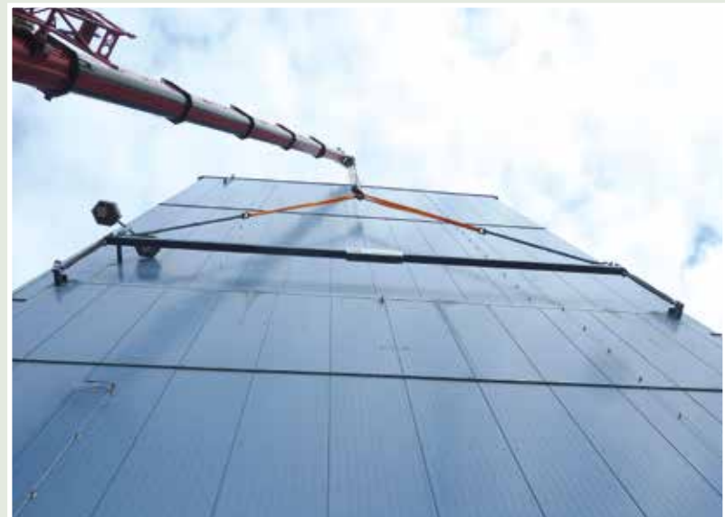
Es geht los: Zum ersten Mal wird das Tor der Materialschleuse ausgehoben.
