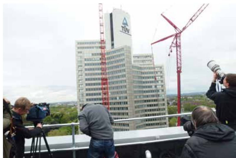
Wolff im Rampenlicht: Bei der Montage des roten Riesen Ende April war das Medieninteresse groß. Kein Wunder, denn für die nächsten zwei Jahre hat Köln neben dem Kölner Dom noch eine weitere Sehenswürdigkeit: Der höchste freistehende Baukran Deutschlands saniert das TÜV Gebäude. Quelle: © Gabor Leitner
