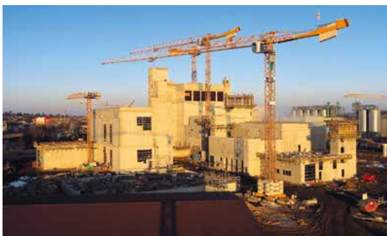
Sechs Turmdrehkrane von BKL sind auf dieser Großbaustelle in Zeitz im Einsatz.
