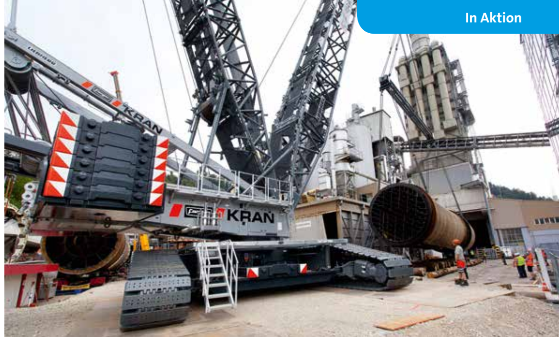
Der Einsatzort bot wenig Platz. Das alte Bauteil wird zwischen Werkshallen und Verwaltungsgebäude abgelegt.
