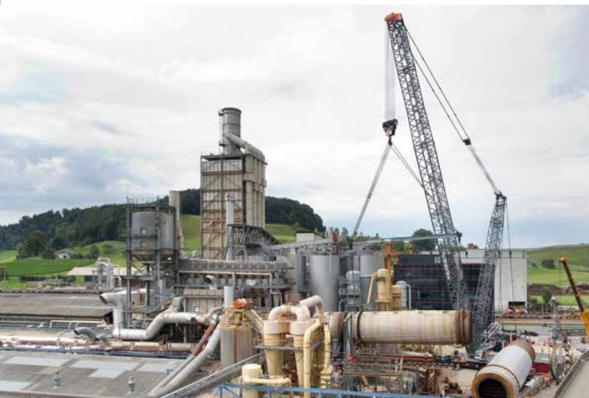
270 t Bruttolast hatte der Liebherr LR 1750/2 zu stemmen: Das alte Bauteil hängt am Haken. Rechts liegt bereits das neue zum Einbau bereit.
