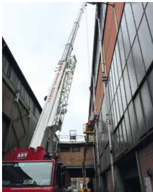
Der ATF 70G-4 ist bei AKV unermüdlich im Einsatz. Auch wenn es einmal eng zugeht, ist das für den 70-Tonner, der seinen Ballast selbst mit zum Einsatzort bringt, kein Problem.
