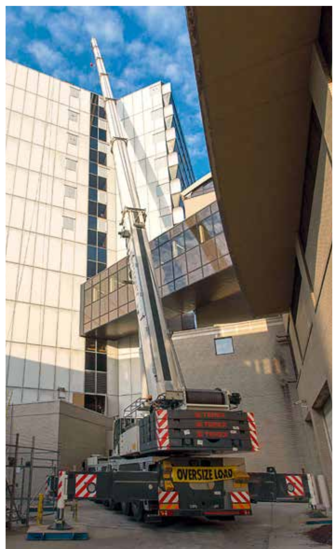
Der Demag AC 250-1 bei der Demontage einer alten Klimaanlage am Krankenhaus in der Innenstadt von Pittsburgh.
