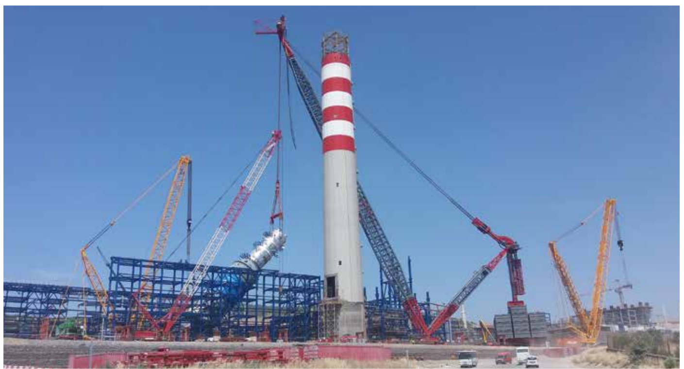
Der AL.SK190 hebt zwei 600 und 800 t Kolonnen an Ort und Stelle. Hier wird die 600 t schwere Kolonne über ein 20 m hohes Rohrgestell gehoben.
