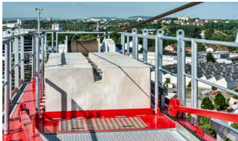
Um die Arbeitssicherheit der Monteure zu verbessern, wurde der Gegenausleger mit speziellen Geländern ausgestattet, in die die Monteure ihre persönliche Schutzausrüstung einhängen können.
