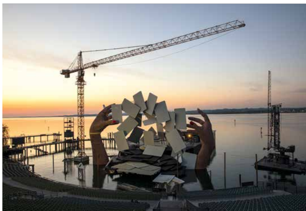
Einsatz am Bodensee: der Liebherr 154 EC-H 6 ist im Wasser verankert und mit einer Hakenhöhe von 33 m im Einsatz. Der Schnelleinsatzkran 71 K kann mit seinem schwimmenden Ponton verschoben werden.
