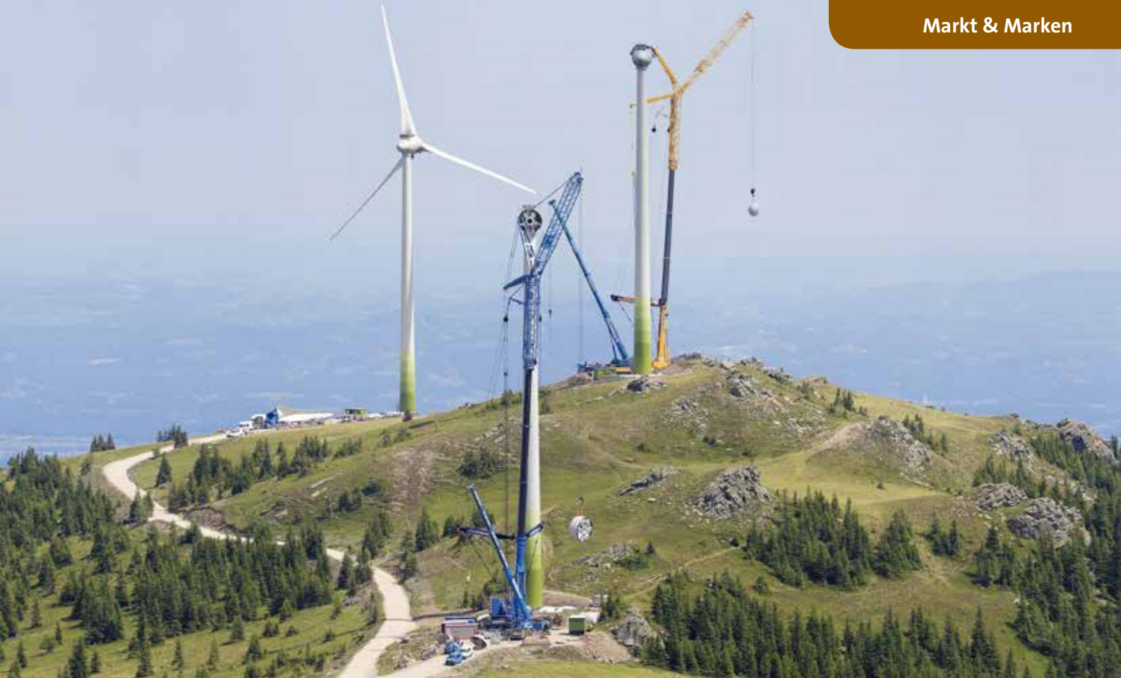
Drei LTM 1750-9.1 errichteten auf der 1.700 m hoch gelegenen Weinebene im Süden Österreichs einen Windpark. Zuvor meisterten die AT-Krane kurve Waldwege und Hänge mit bis zu 20 % Steigung.
