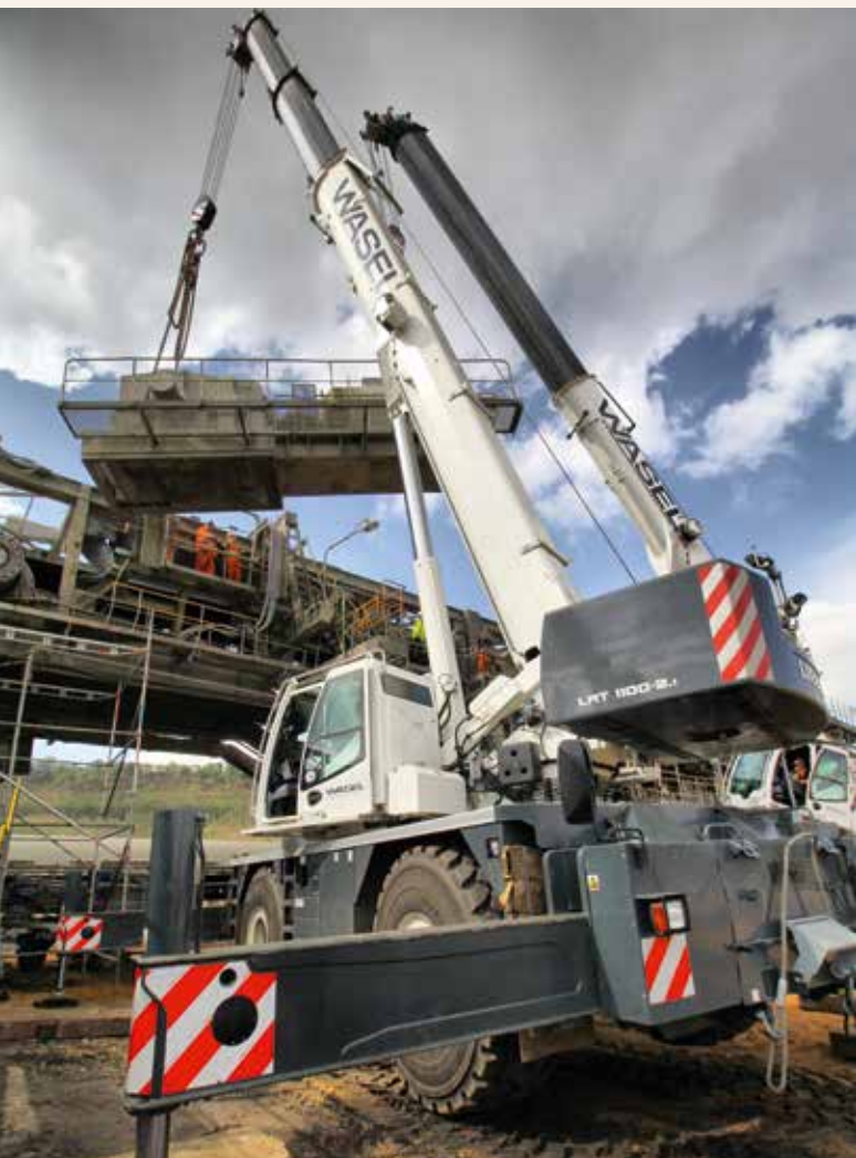
Behutsam wird der tonnenschwere Bandantrieb zwischen den Auslegern beider Krane hindurch geschwenkt.
