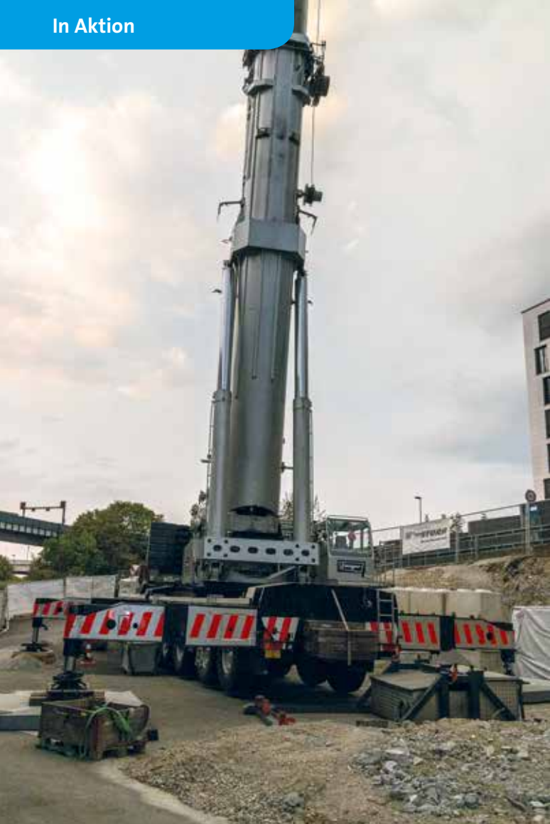
Fanger setzt für die Arbeiten seinen Liebherr LTM 1500-8.1 ein. Bild: Erich Urweider
