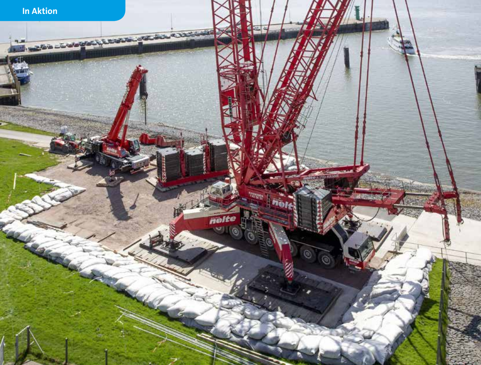
Fester Stand: Bereits 2017 wurde der mit Bohrpfehlen gegründete Stellplatz für den Gittermast-Fahrzeugkran erstellt.
