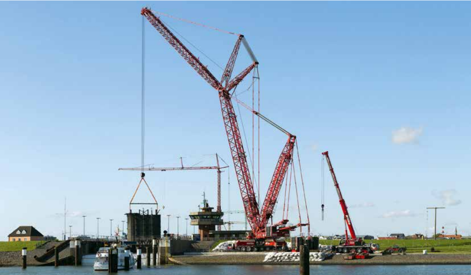
Imposantes Kraftpaket: Der LG 1750 hat das erste der sechs Schleusentore des Sperrwerks in Büsum am Haken.
