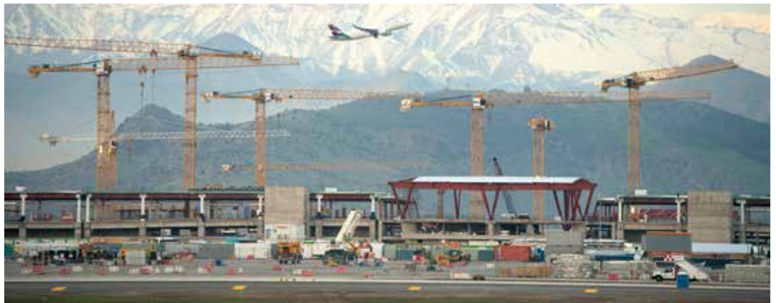
Beim Flughafenbau sind die erlaubten Kranhöhen sehr limitiert. Um dennoch mit vielen Kranen auf engstem Raum arbeiten zu können, montierten die Servicetechniker für den Bau eines der Terminals einen Flat-Top-Kran 250 EC-B 12 Litronic auf Schienen.
