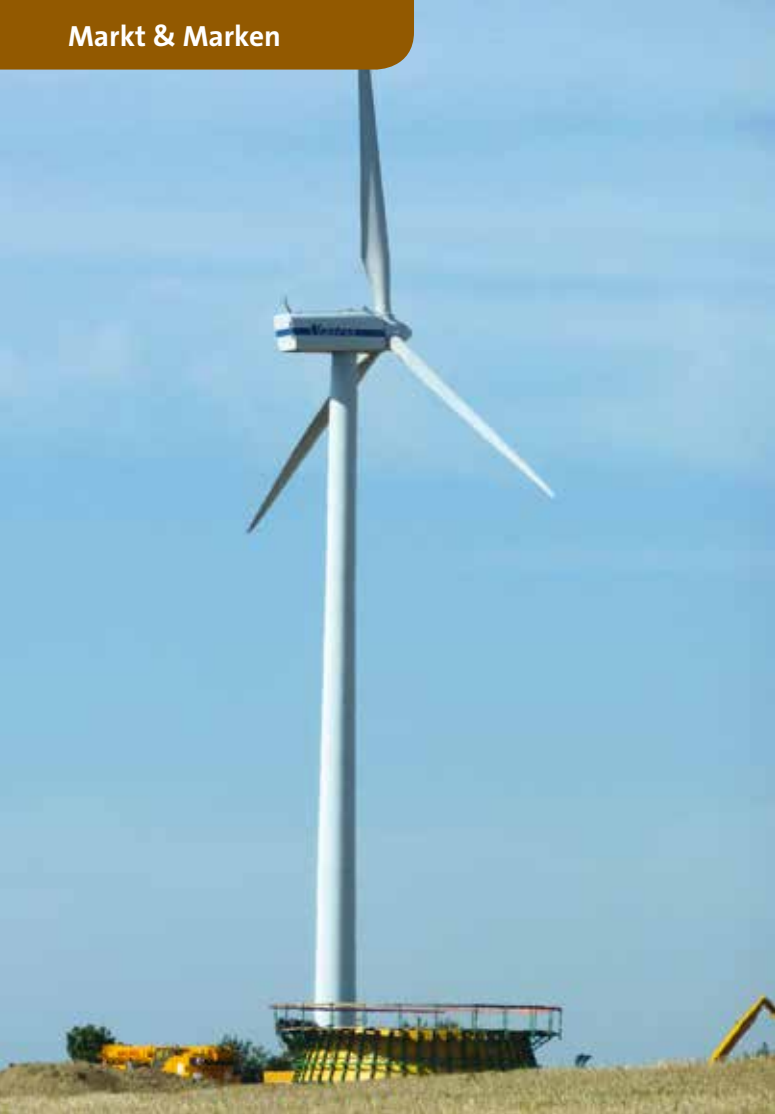
Im Vordergrund entsteht das Fundament für eine neue Anlage – im Hintergrund eine ältere WEA: Repowering könnte das Windenergiegeschäft in Zukunft beherrschen.
