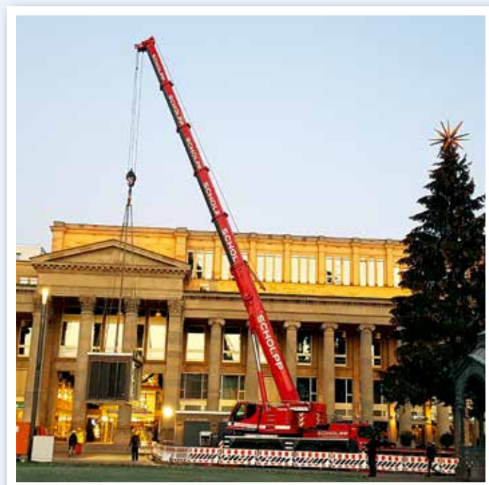
Einsatz für Scholpp auf dem Stuttgarter Weihnachtsmarkt. In diesem Jahr ist wieder der „Aromatesor“ erlebbar. Er besteht aus zwei Modulen, die von der Spedition Kübler auf den Schlossplatz geliefert werden und von Scholpp mit dem S-HK 120 gehoben und montiert werden.
