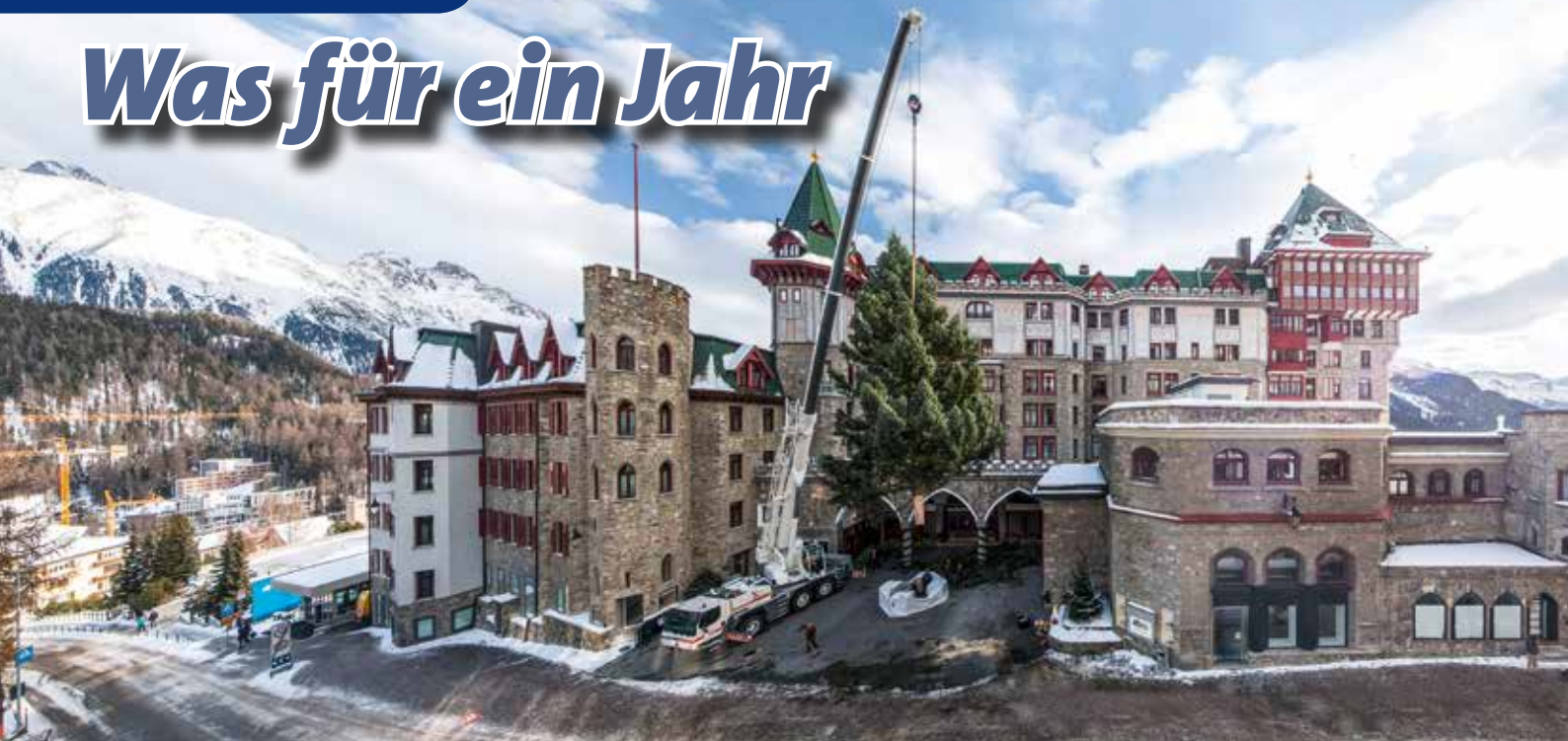
Das Schweizer Unternehmen Nicol, Hartmann & Cie. mit Sitz in St. Moritz ist auf Hoch- und Tiefbau spezialisiert. Umso mehr stellt dieser „Weihnachts-Einsatz“ für das Bauunternehmen eine schöne Abwechslung dar: Mit dem eigenen Liebherr-Mobilkran LTM 1060-3.1 stellt das Unternehmen einen 12 m hohen Weihnachtsbaum vor dem Luxushotel Badrutts Palace in St. Moritz auf. Weihnachtlich geschmückt ziert die 3 t schwere Tanne den Eingang des 5-Sterne Hotels.
