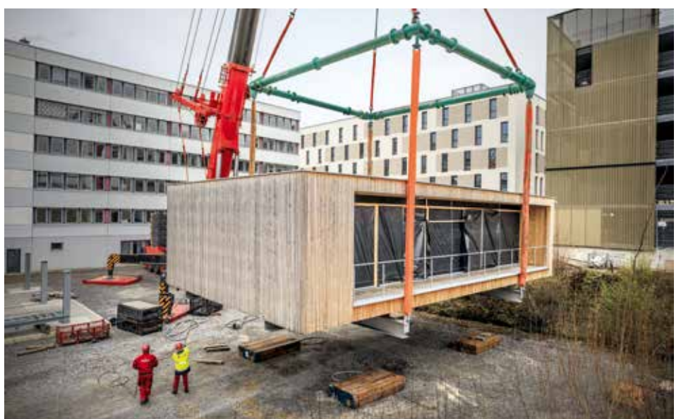
Abheben – die Erste: Scholpps 700-Tonner S-GK 700 hebt „Big Room“ von den Stützen.
