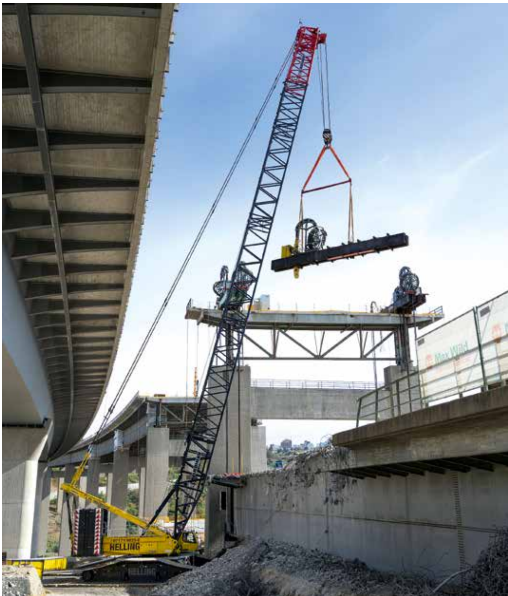
Ebenfalls an der Talbrücke Heidingsfeld im Einsatz. Der LR 1600/2 des Kranbetreibers Helling, der beim Hub von Litzen-Hebetechnik über 100 t am Haken hatte.
