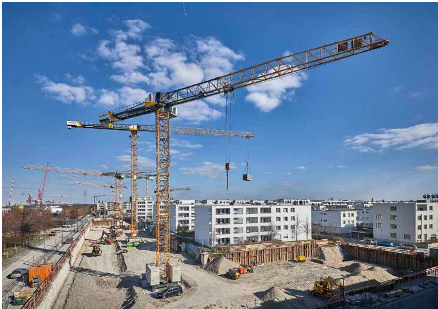
Während Liebherr auf dem Messegelände die neue EC-B-Kranreihe vorstellte, hatte BKL zwei 340 EC-B 16 und einen 340 EC-B 12 beim Bau einer Wohnanlage in der Messestadt Riem im Einsatz.
