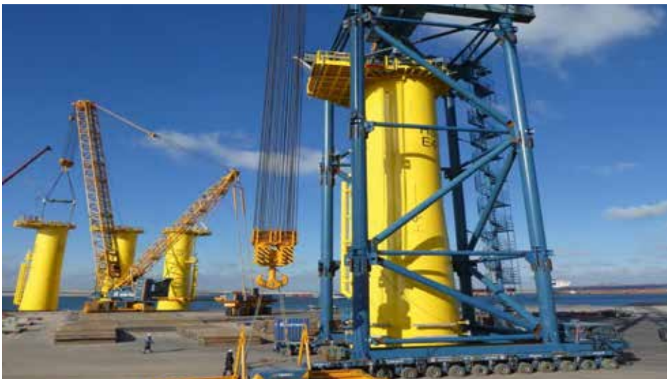
Im Bereich „kombinierte Techniken“ konnte sich Sarens B.V. über einen Award freuen und wurde für den Umschlag von bis zu 1.100 t schweren Transition Pieces und Monopiles ausgezeichnet. Zudem erhielt das Unternehmen den Award im Bereich Mobilkraneinsatz über 120 t Tragkraft.
