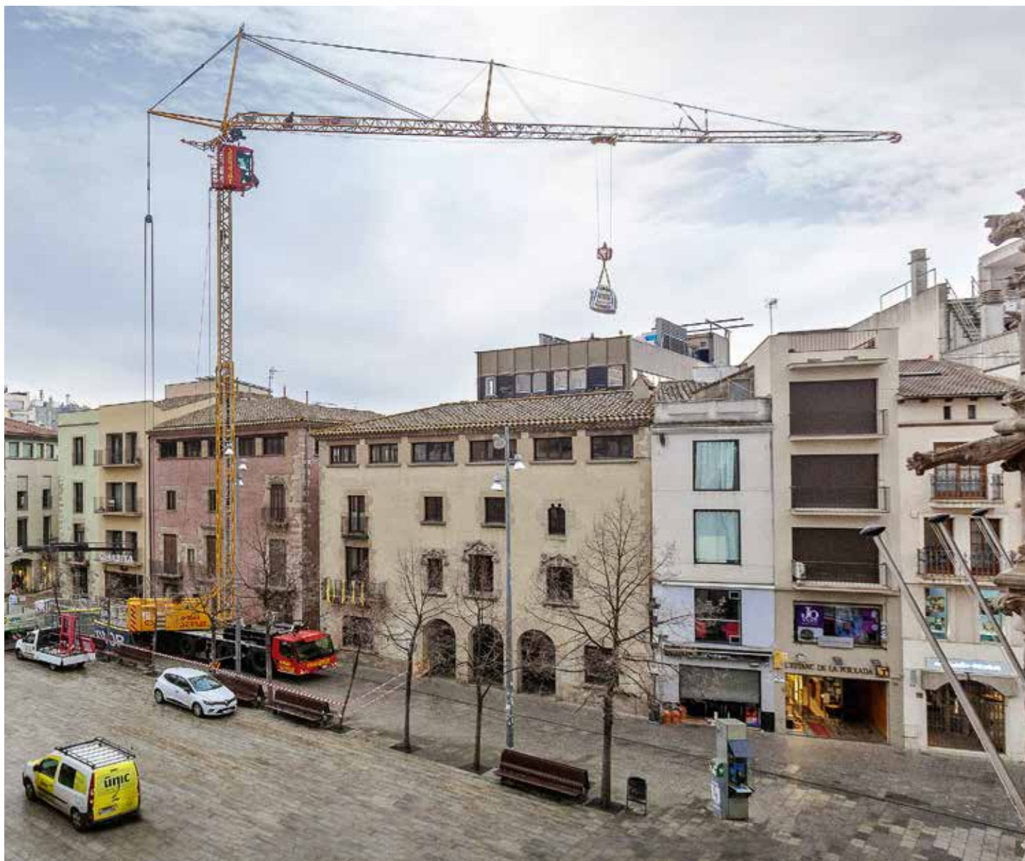
Der neue MK 88 Plus von Grúas Serrat SA bei Sanierungsarbeiten in Granollers auf dem berühmten Platz „Plaça de la Porxada“.
