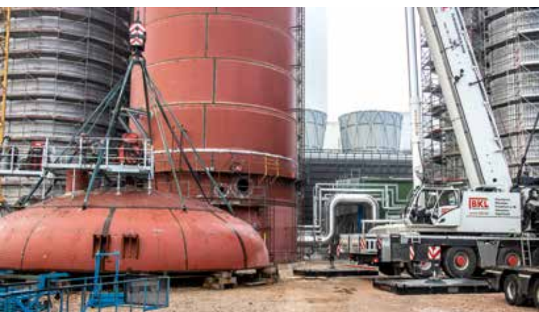
Der Behälter Durchmesser beträgt 12 m.
