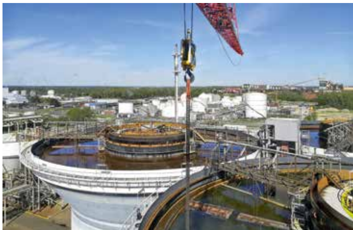
Über einen Zeitraum von rund neun Wochen war der Liebherr-Mobilbaukran MK 140 am Klärschlamm-Reaktor nahezu täglich rund zehn Stunden pro Tag gefordert.
