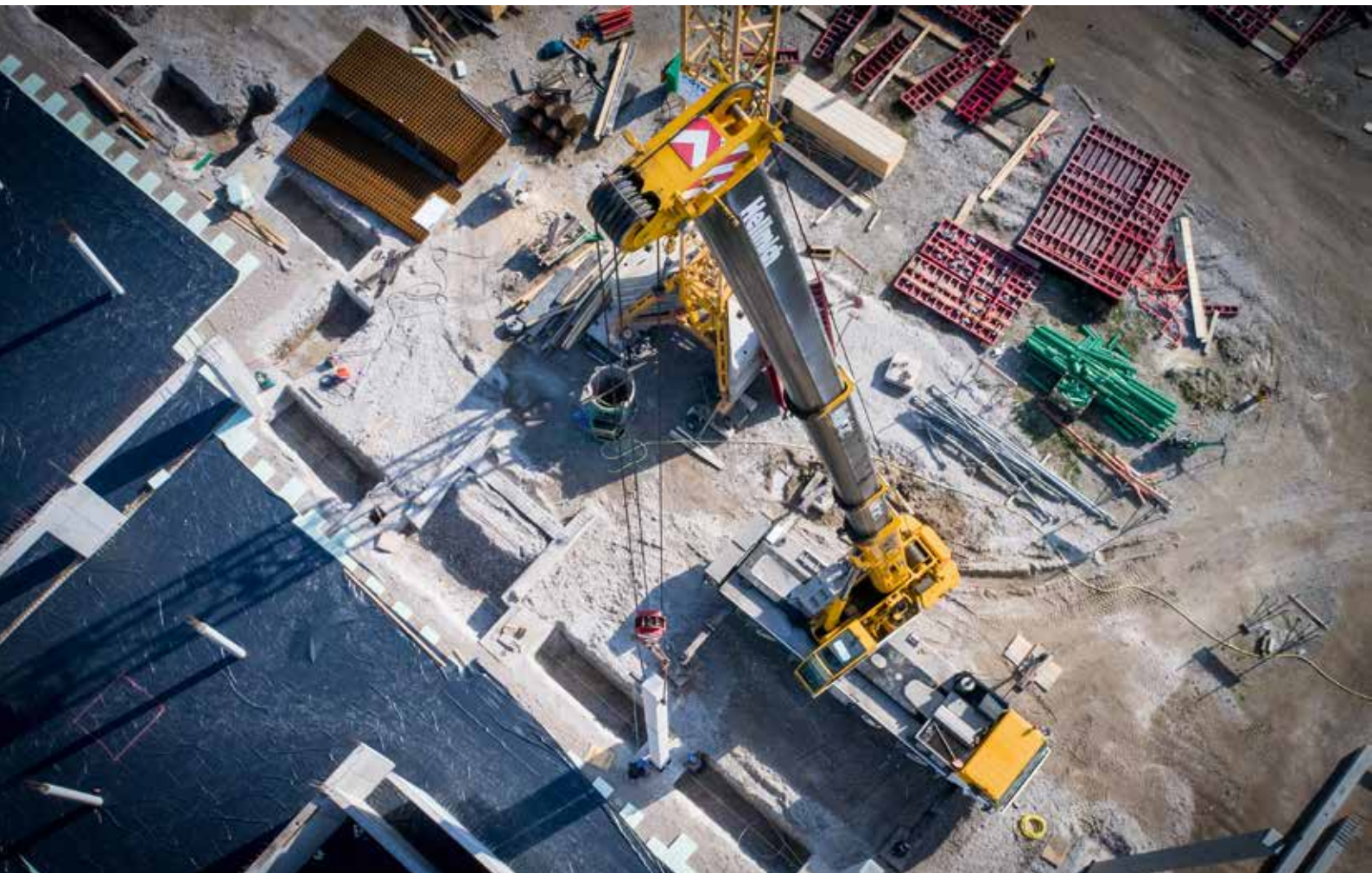
Der Grove GMK 5250L beim Einsatz auf der Gegengeraden-Baustelle im Stadion des SV98 in Darmstadt.
