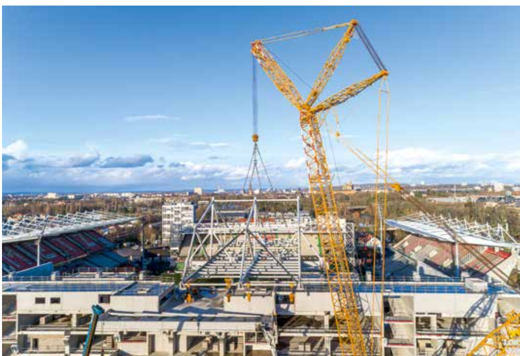
Zu Einsatz kam der CC 3800-1 mit mit 60 m Hauptausleger, 36 m Superliftmast und 24 m langem wippbaren Hilfsausleger.
