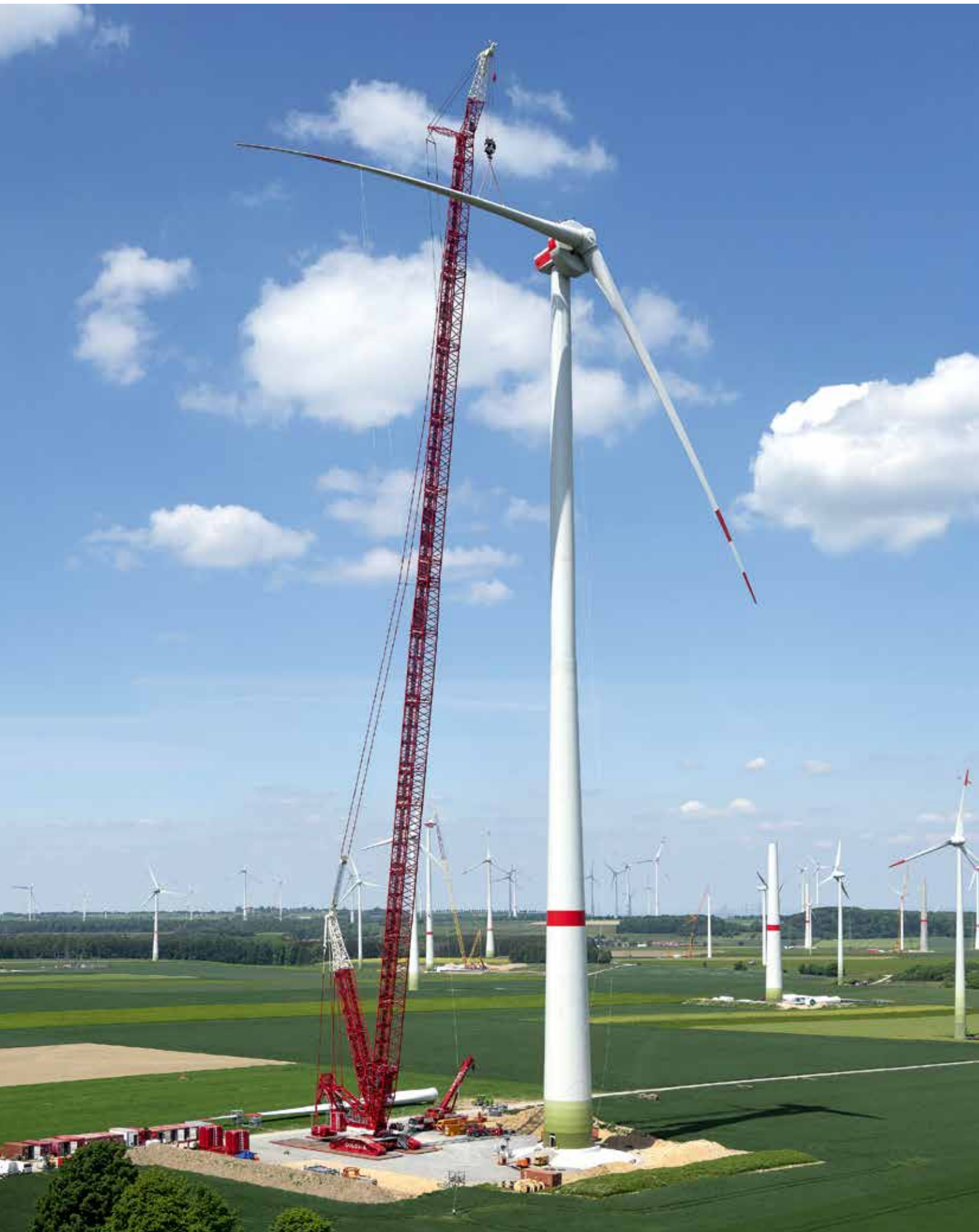
Rotorblattmontage. Die Enercon-WEA kann 4,2 MW Strom erzeugen und hat eine Nabhöhe von 160 m. Der Rotordurchmesser beträgt 138 m.
