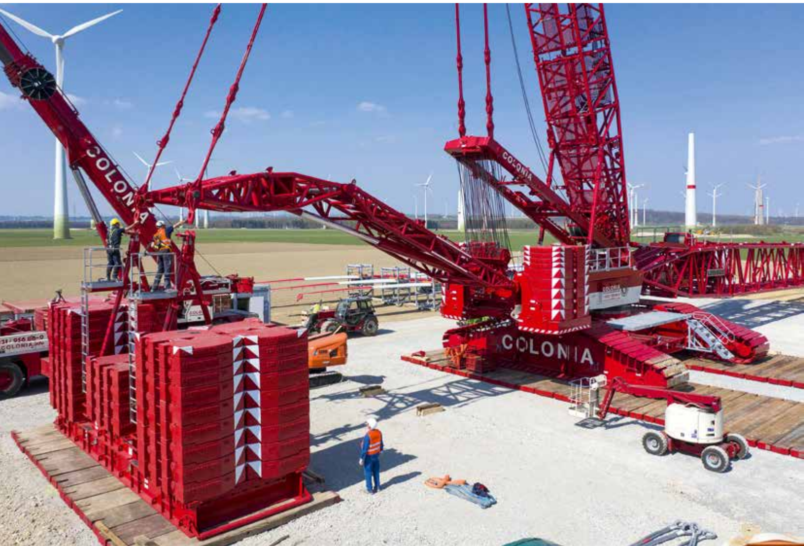
400 t Schwebeballast werden an den Klapprahmen namens „V-Frame“ gehängt, die lediglich zum Aufrichten und Ablegen des Gittermastes erforderlich sind.
