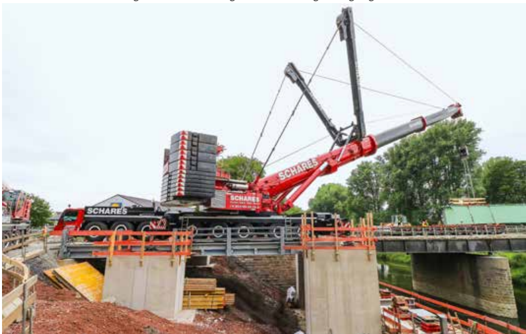
Auf eigens für die Hübe gefertigten Betonfundamenten abgestützt, entlasten die Krantransportfahrzeuge beim Einfahren, um Schäden an der Bestandsbrücke zu vermeiden.
