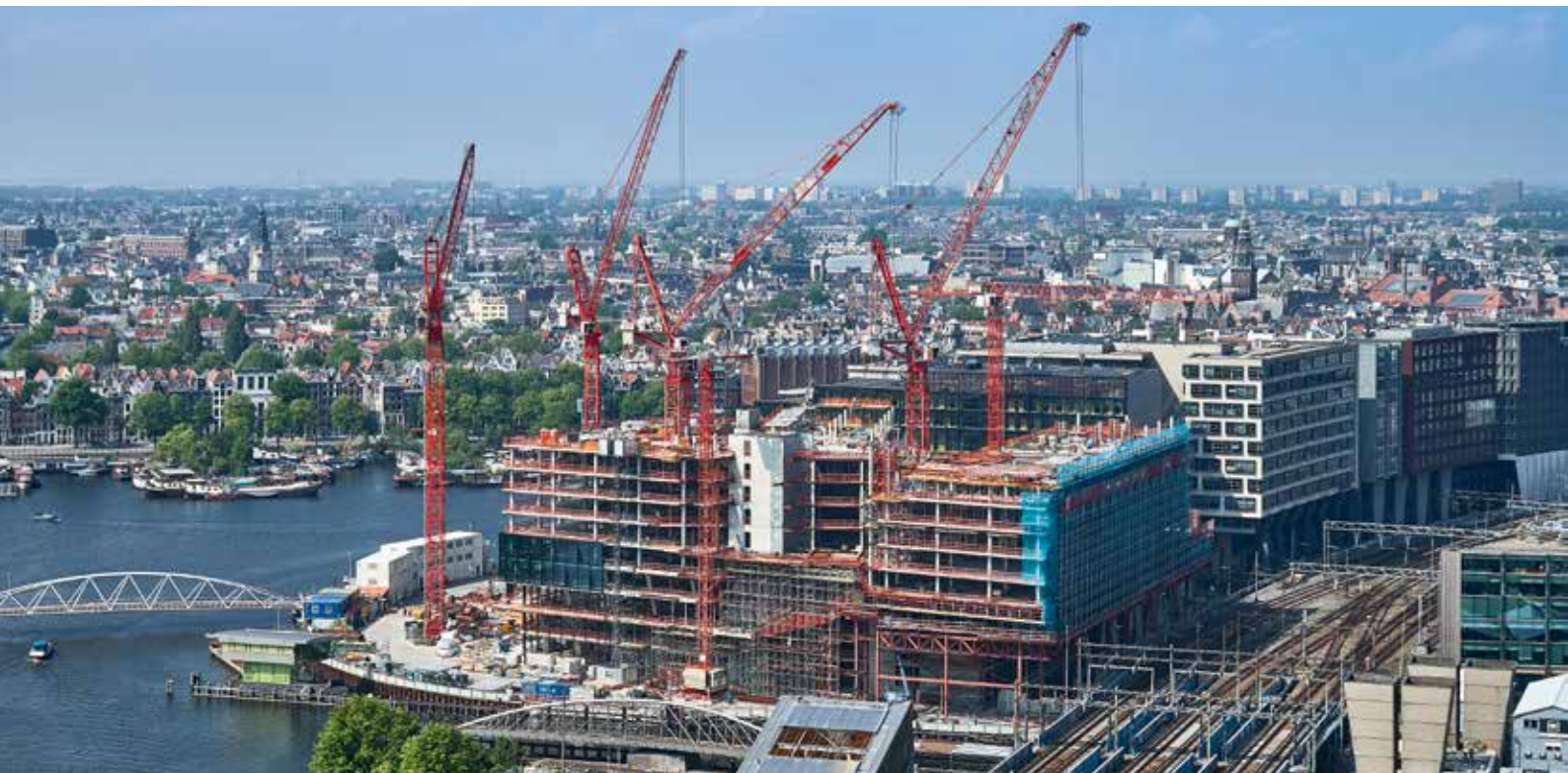
Im Herzen von Amsterdam entsteht auf dem Oosterdokseiland das moderne Multifunktionsgebäude ODE. Sieben Wolff-Krane sind hier im Einsatz.
