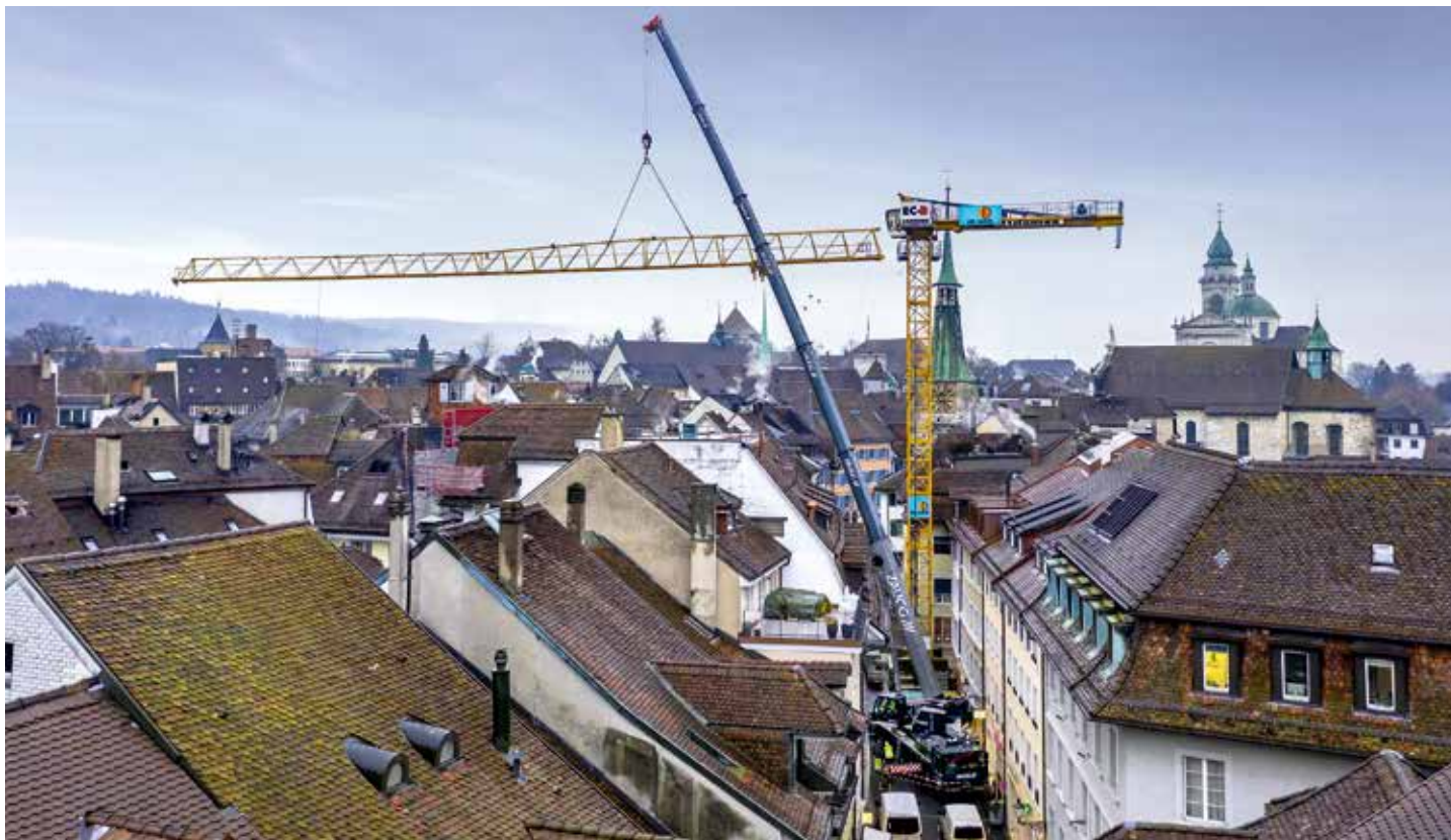
Wie eingeklemmt wirkt der LTM 1110-5.1 von Zaugg, der in einer schmalen Altstadt-Gasse im schweizerischen Solothurn einen Baukran von Liebherr demontiert.
