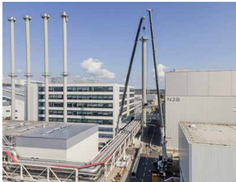
Verheben Segment 1: Der LTM 1230-5.1 von BKL hebt das untere Bauteil mit rund 16 Tonnen Gewicht und 28 Metern Länge an seinen Bestimmungsort.
