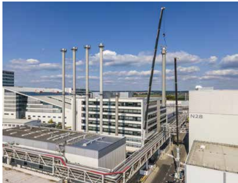
Verheben Segment 2: Mit viel Fingerspitzengefühl hebt der BKL Kranfahrer den zweiten, 27 Meter hohen Teil des Kamins.
