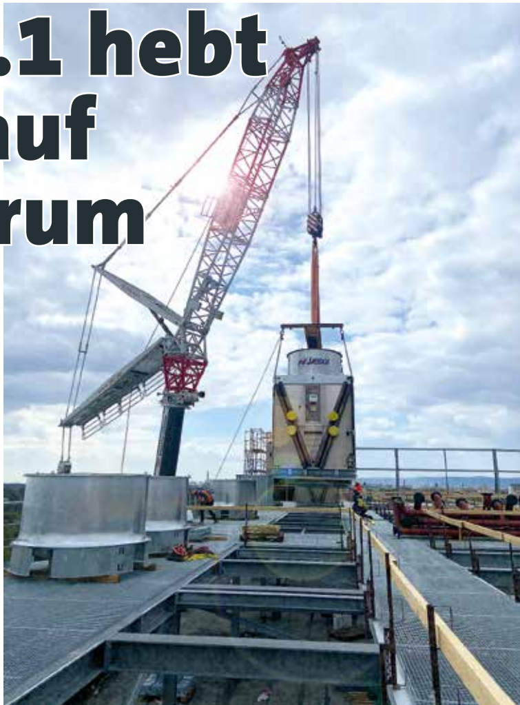
Der LTM 1450-8.1 von BKL Frankfurt platziert die 20- und 40-Tonnen schweren Teile im Auftrag des englischen Kunden punktgenau auf dem neuen Rechenzentrum.
