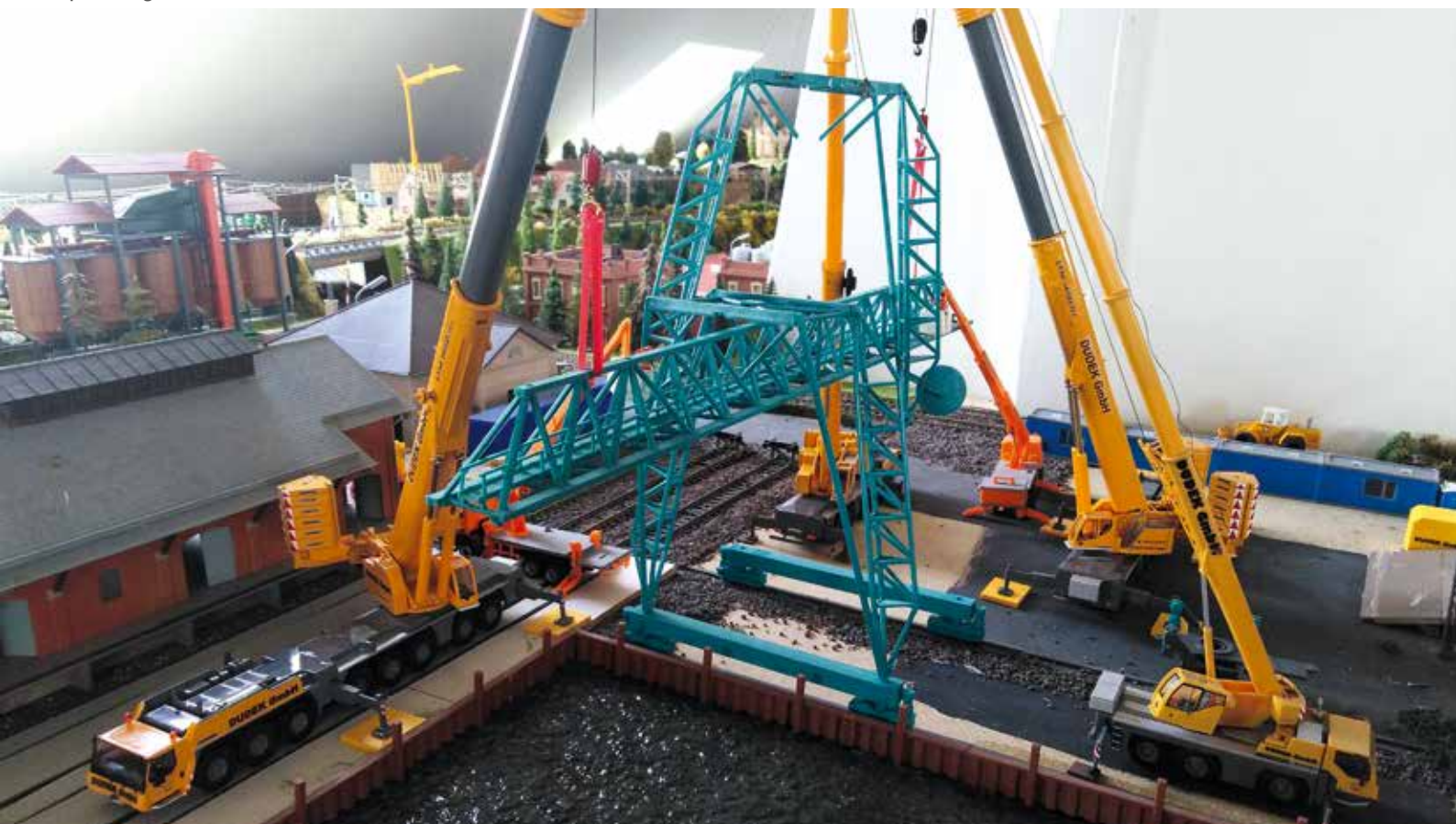
Demontage einer alten Containerbrücke. Zwei LTM 1450 halten die Kranbahn in Waage, während ein LTM 1250 zunächst die hintere, danach die vordere Stütze heraushebt. Der LTM 1045 dient hier als Hilfskran zum Ablegen der Stützen und zum Verladen für den Abtransport. Zwei Steigerwagen waren ebenfalls im Einsatz.
