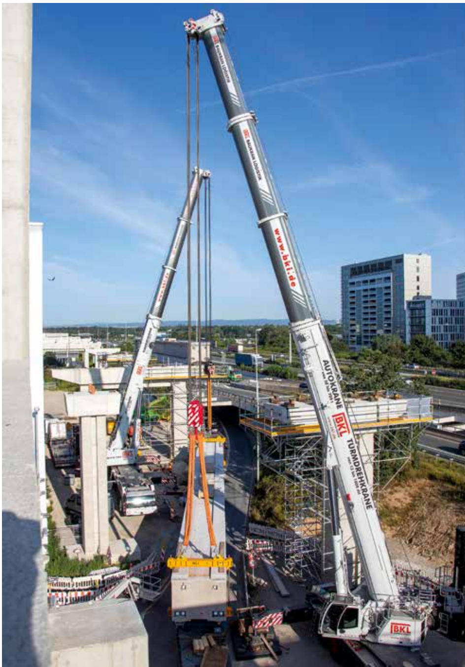
Im Tandemhub heben ein LTM 1650-8.1 und ein LTM 1450-8.1 von BKL fast 200 Tonnen schwere Fahrbahnelemente. Bild: BKL Baukran Logistik / www.borisgolz.de
