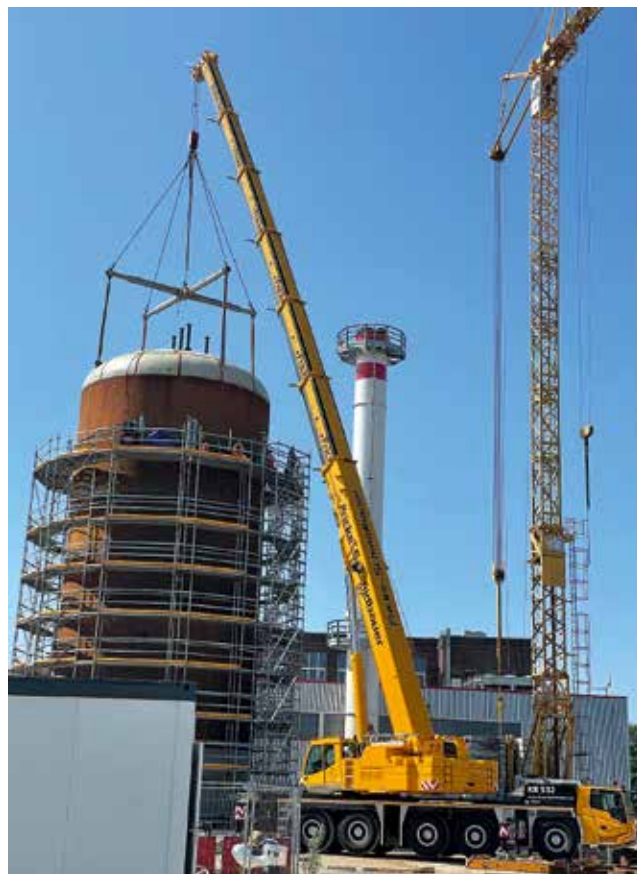
Der ATF-220-5.1 im Premiereinsatz bei Fricke-Schmidbauer: Der Kran hob einen 32 t schweren Deckel auf den Kessel eines Fernwärmekraftwerks.
