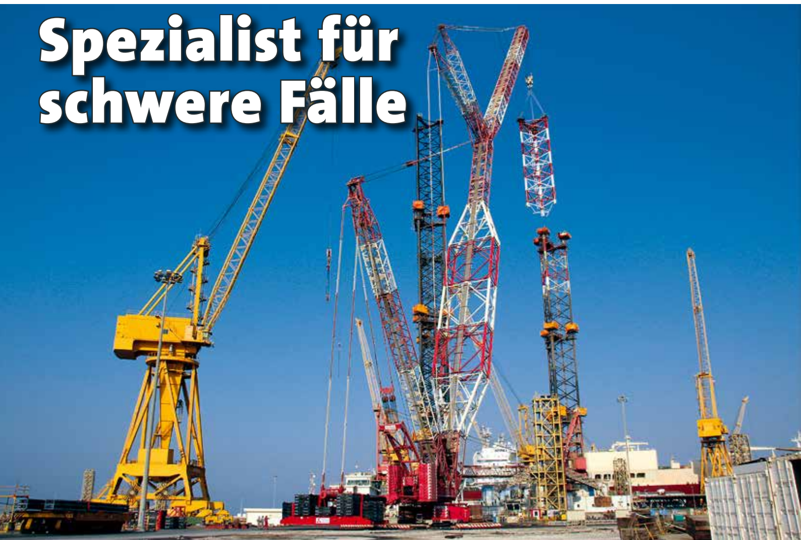
Einhub von schweren Teilen der Stützkonstruktion der Hubplattform Rumailah Lift Boat auf der Werft in Ras Laffan.
