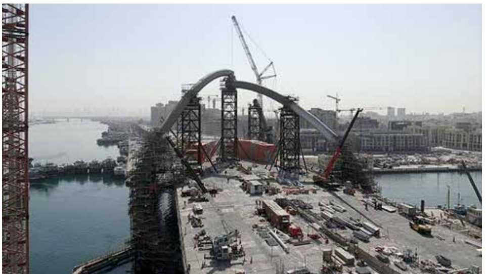
Der CC 8800-1 trug den größten Teil des Gewichts, während die Segmente auf der gegenüberliegenden Seite der Brücke positioniert wurden.
