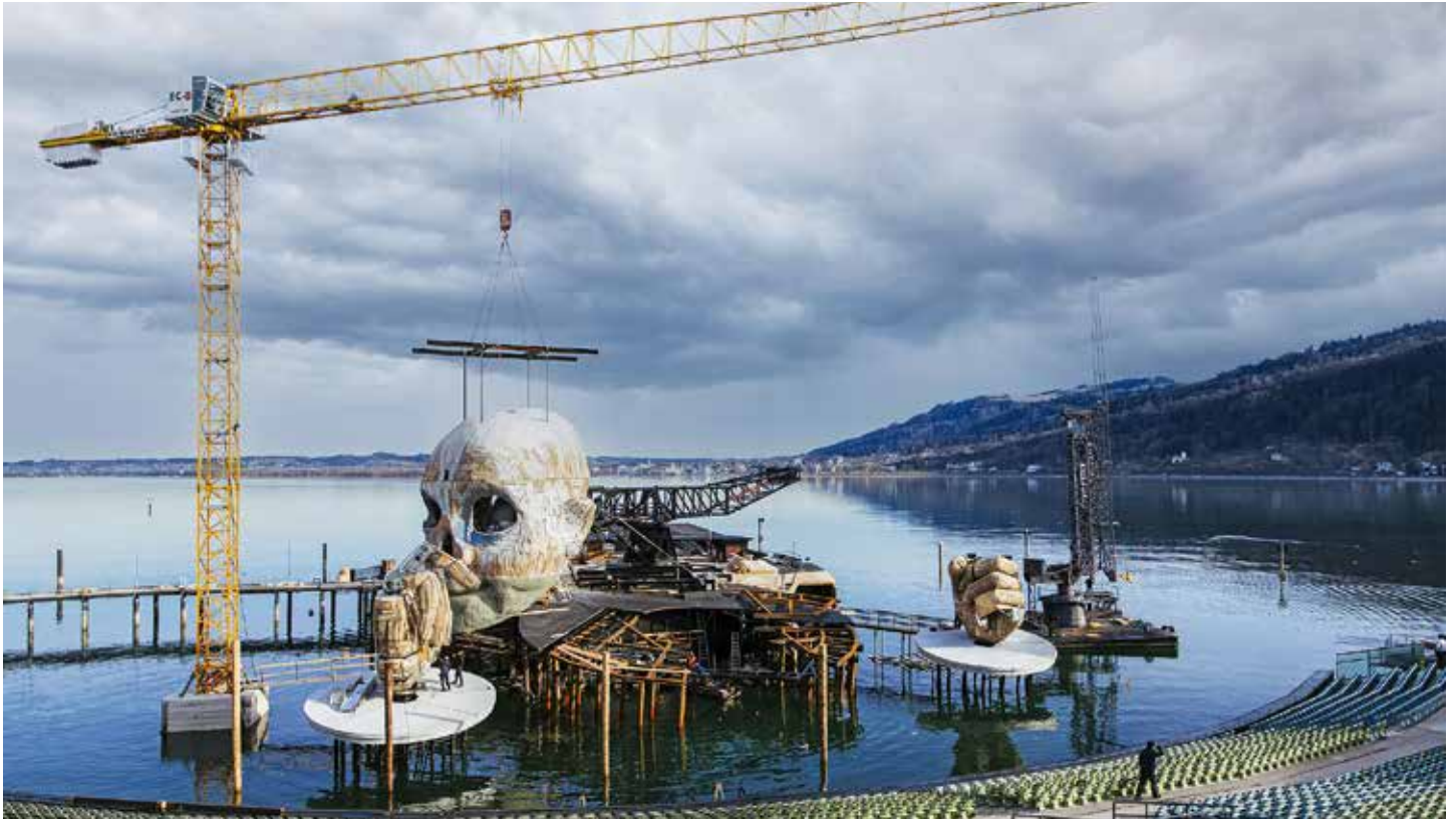
Mit einem 150 EC-B, der auf einem Fundament im Bodensee steht, wird die Kulisse der Seebühne Bregenz demontiert.
