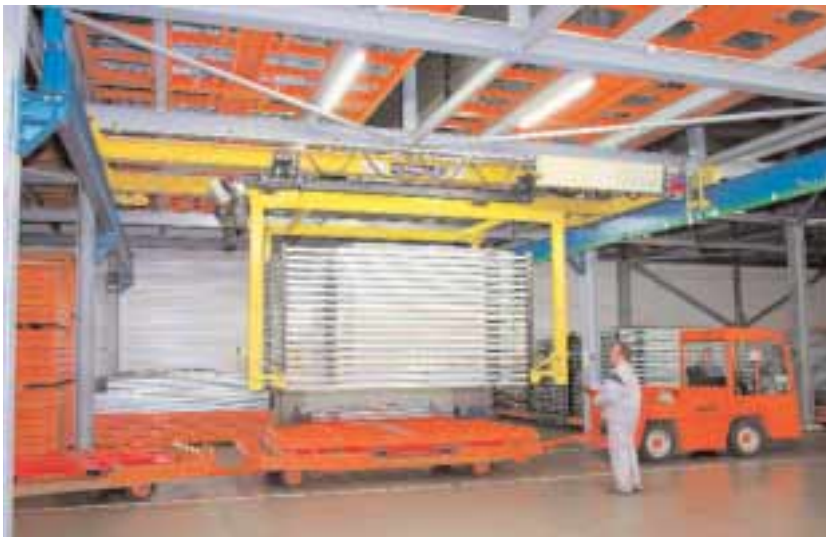
Der funkgesteuerte Kassettenkran von R. Stahl ist ein Zweiträgerlaufkran mit einem Spurmittenmaß von 8 m und einer Gesamttraglast von 3.200 kg.
