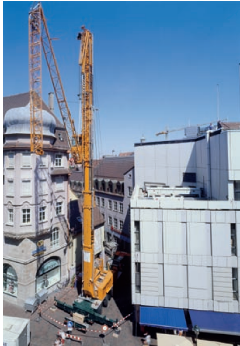
Nach dem 4-achsigen MK 80 mit 80 mt Traglast stellte Liebherr auf der Bauma 2004 den MK 100 vor. Das Einsatzbild dokumentiert sehr gut eine der Stärken der Mobilbaukrane: Egal wie eng es ist, die Montage ist immer noch möglich und die Störkanten stören auch nicht weiter.
