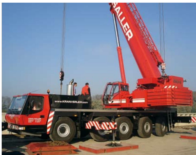
Erfüllte alle Anforderungen, die für den Einsatz im Zentrum von Deggendorf notwendig waren: der Grove GMK 5130-1.
