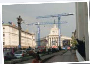
Mit Hakenhöhen von 26,5 m und 53,9 m sind die beiden Linden Comansa-Krane im Einsatz.
