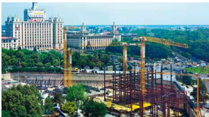
Die eingesetzten Liebherr-Krane sind mit stufenlosen Antrieben ausgestattet. Sämtliche Lasten bis maximal 6 t werden im 2-Strang-Betrieb gehoben.
