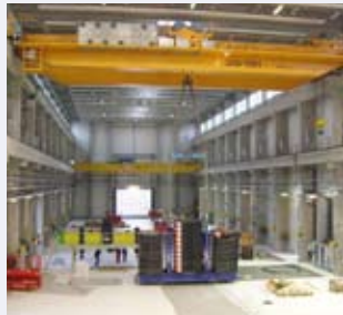
Vollständige Kranprüfung nur mit Lastprüfung
